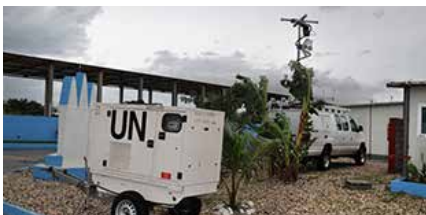
Imagem 12: Geradores: a disponibilidade inicial foi rapidamente ultrapassada e teve que ser continuamente ampliada Fonte: BRASIL. Exército Brasileiro. BRABATT 1 prepara instalações em apoio à MINUSTAH. Disponível em: < http://www.eb.mil.br/web/haiti/brasil-no-haiti/-/asset_publisher/ej0lvyd91BVf/content/brabatt-1-prepara-instalacoes-em-apoio-a-minustah >. Acesso em: 16 jul. 2018.
